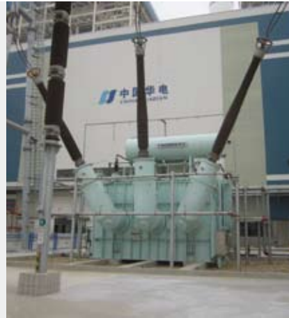
沈变——莱州 DFP-380MVA/500KV Shenyang transformer-Laizhou DFP-380MVA/500KV
