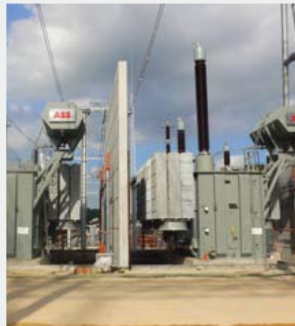
重庆ABB——无锡惠泉变扩建工程 ODFS – 334MVA/500KV Chongqing ABB-Huiquan, Wuxi, Variable expansion project ODFS 334MVA/500KV
