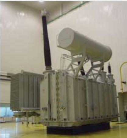
保变——辽中 ODFS – 334MVA/500KV Baoding Tianwei-Middle of Liaoning province ODFS 334MVA/500KV
